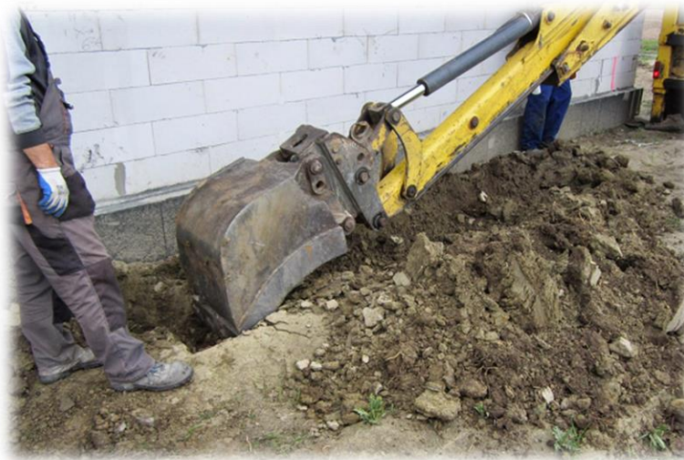
2. Doprowadzenie ścieku do oczyszczalni.
