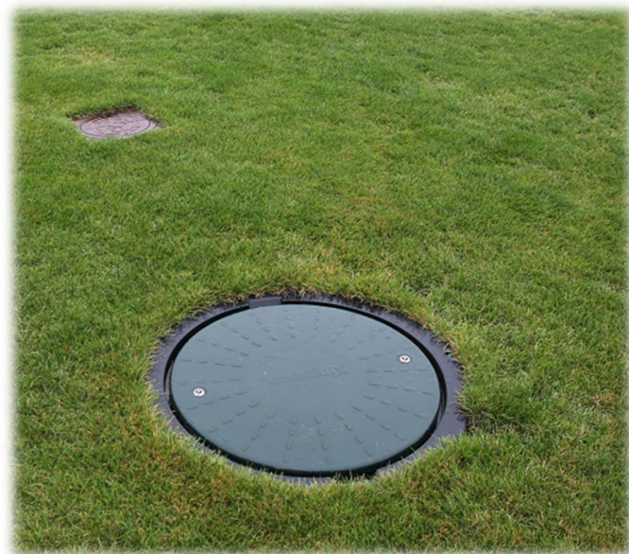
Pojedynczy właz to estetyczna instalacja.
